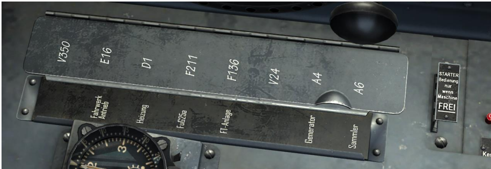
Abb. 86: Abdeckung der Selbstschalter geschlossen
